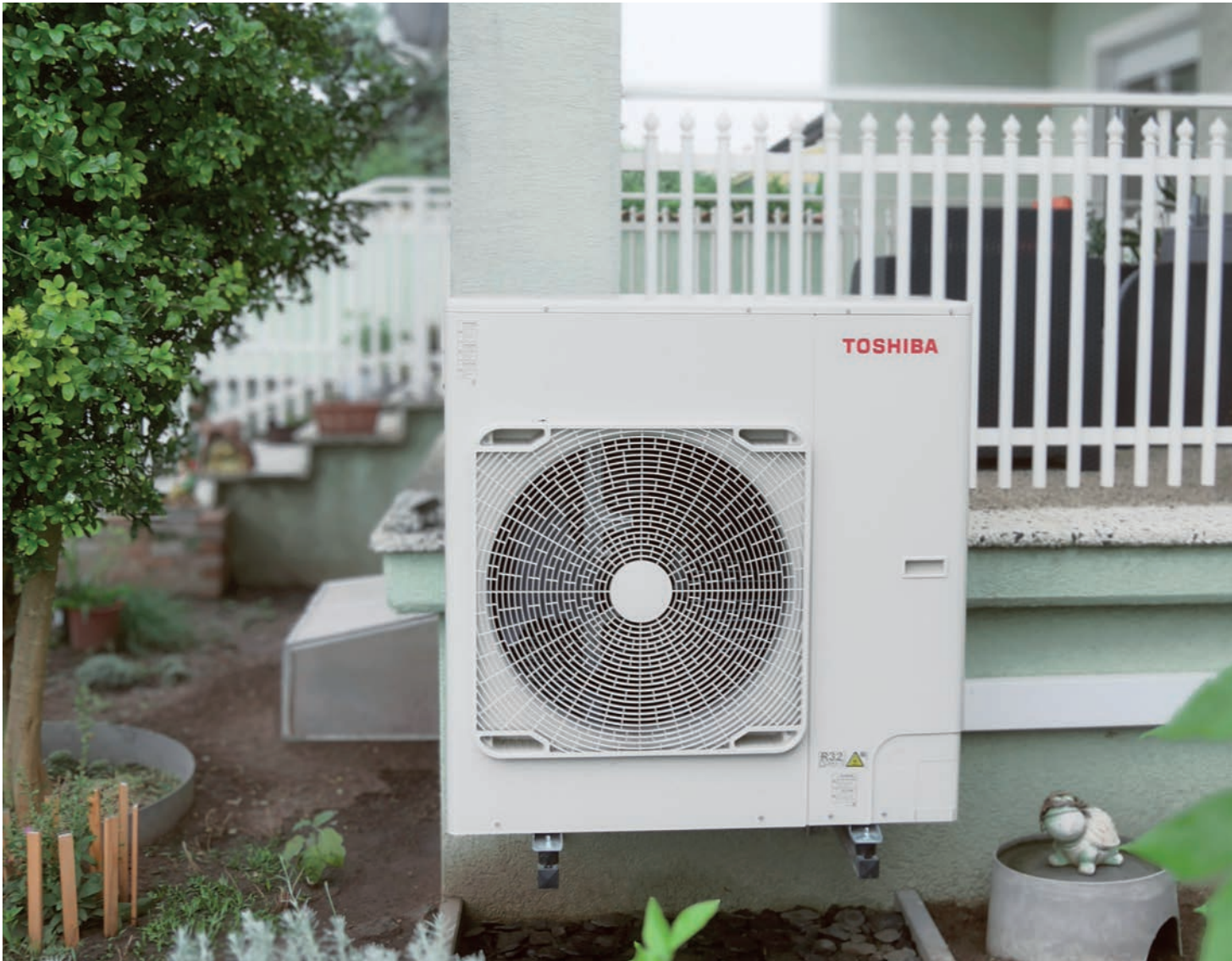
Családi ház Podersdorfban, Robert Müllner GmbH - Kälte Klima Installateur
